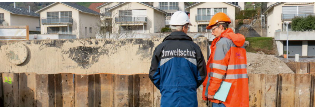
Besprechung auf der Baustelle: Die erforderlichen geologischen Leistungen und Nachweise müssen rechtzeitig ausgelöst werden. Bild: zvg.
