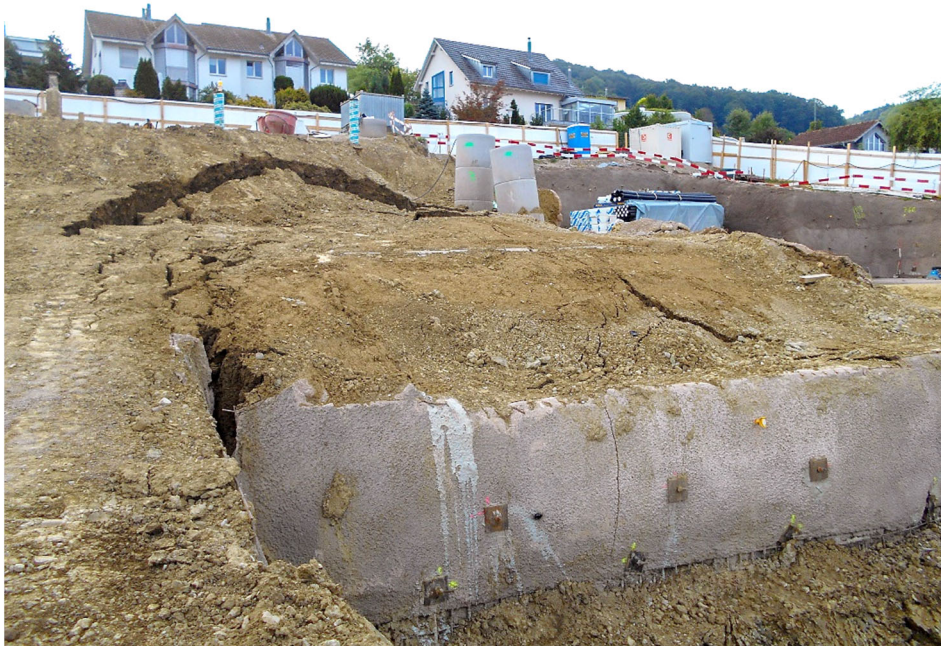
Abb. 2: Baubedingt ausgelöste Instabilität in einem rutschanfälligen Gebiet
